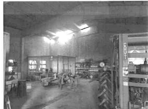
17- Copertura danneggiata del magazzino
