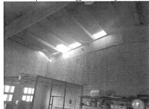
18 – Copertura danneggiata del magazzino
